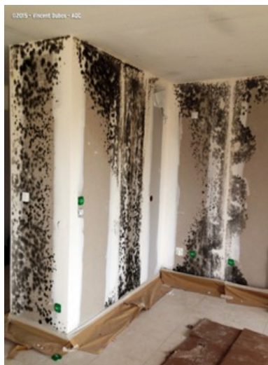
Figure 8 – Moisissures sur parois
